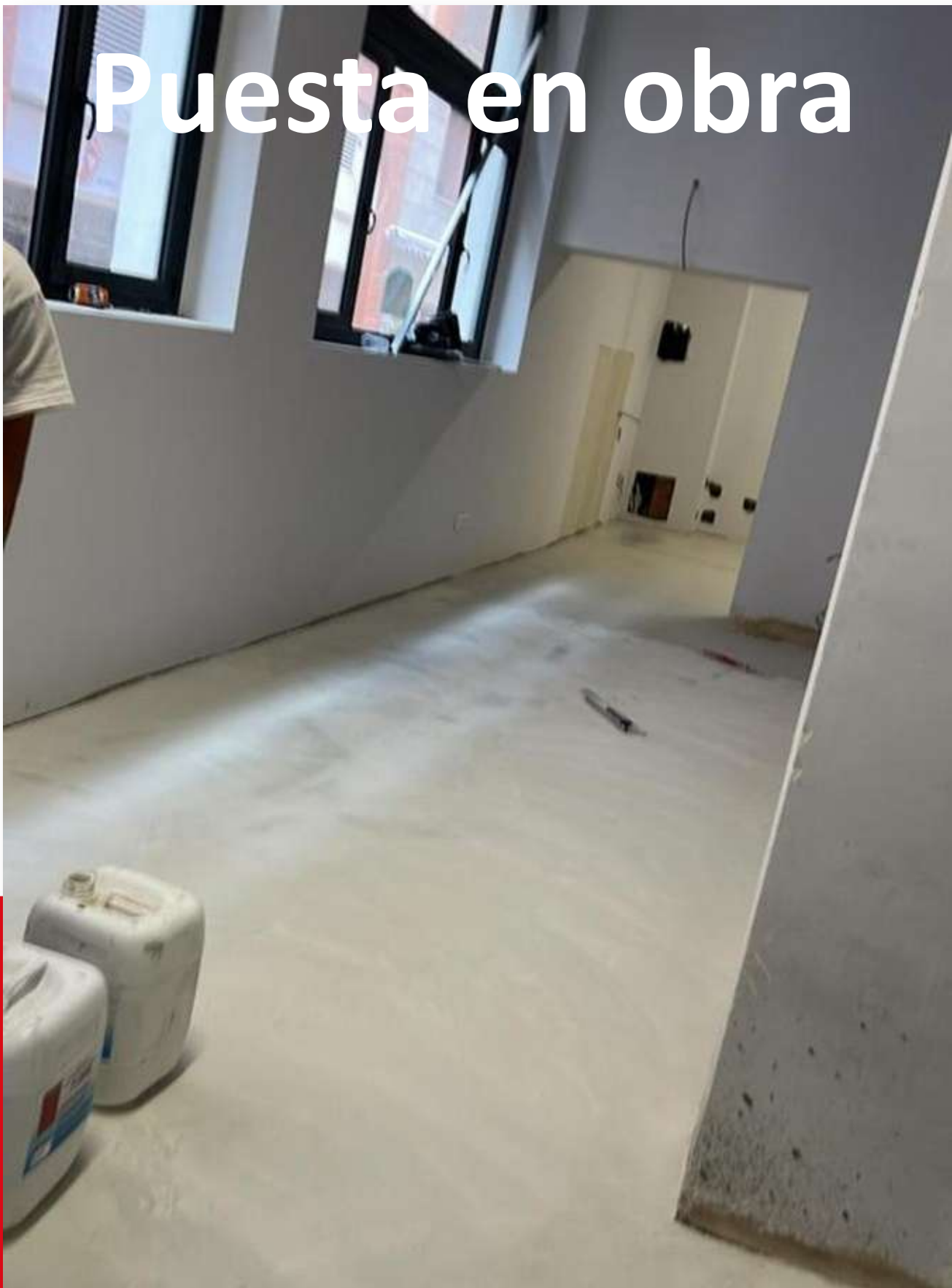
Detalle actual: Diferentes zonas de paso, juntas a tener en cuenta y derrames de producto.
