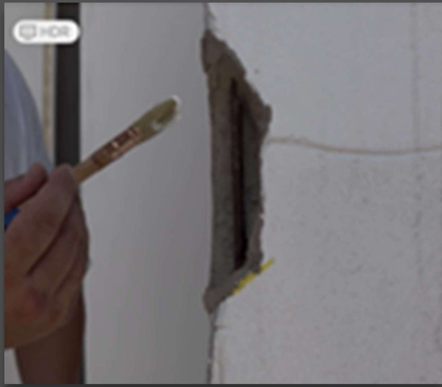
2. Soporte limpio, sin oxido ni desconchones.
