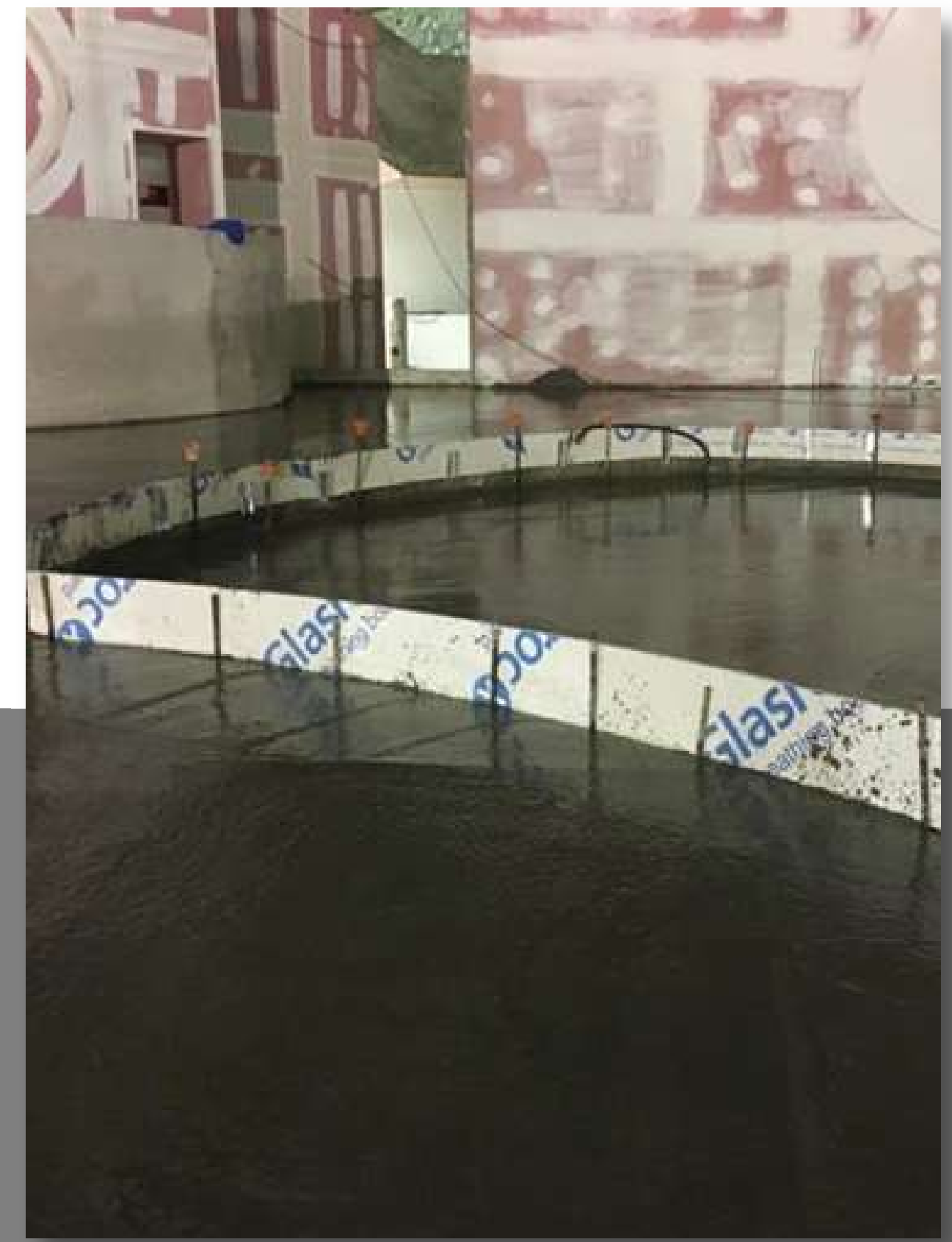
Elementos técnicos: El cálculo de juntas perimetrales y de dilatación son muy importantes.
