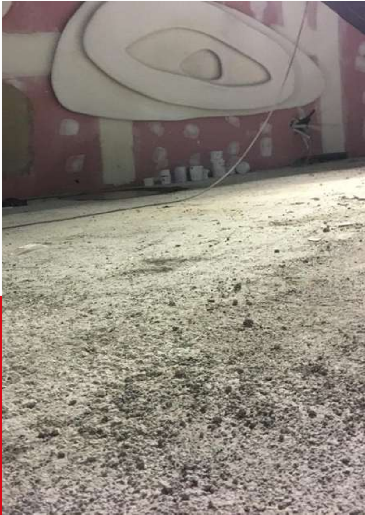
Detalle actual: Preparación de las superficies de diferentes zonas con paso y cálculo del tráfico futuro.
